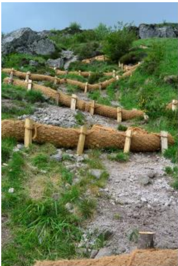
Toilage en bionatte de fibre de coco et boudins en fibre de coco pour lutter contre l'érosion (fermeture des ravines)
