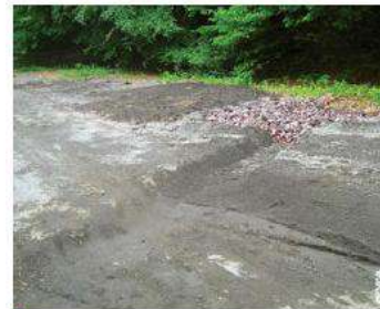
↑ Renvoi d'eau naturel (ou tranchée à merlon) se déversant dans le puits perdu (Chemin des Gravouses)
