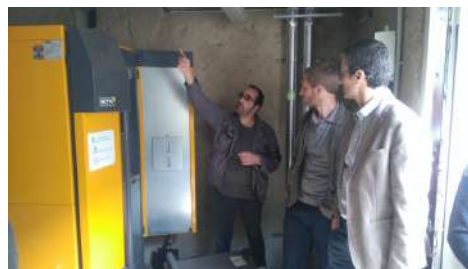
Visite de la chaufferie bois du SMPNRVA le 30 mai 2018 © Aduhme
