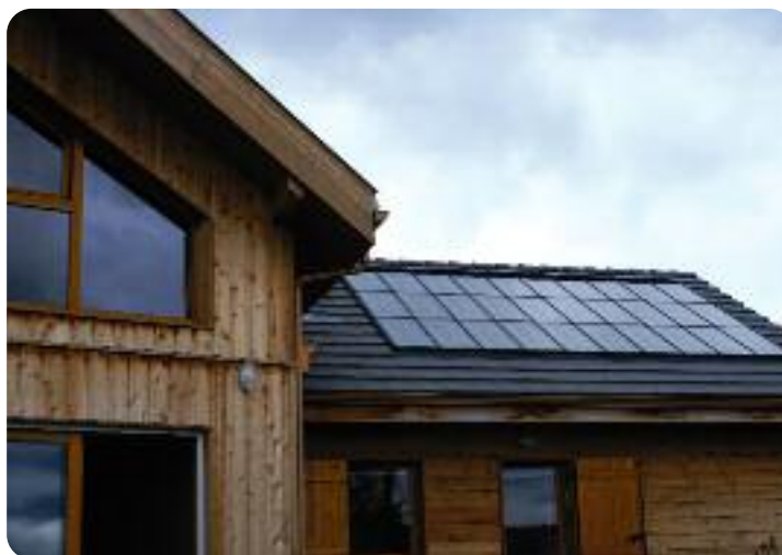
Panneaux solaires thermiques
